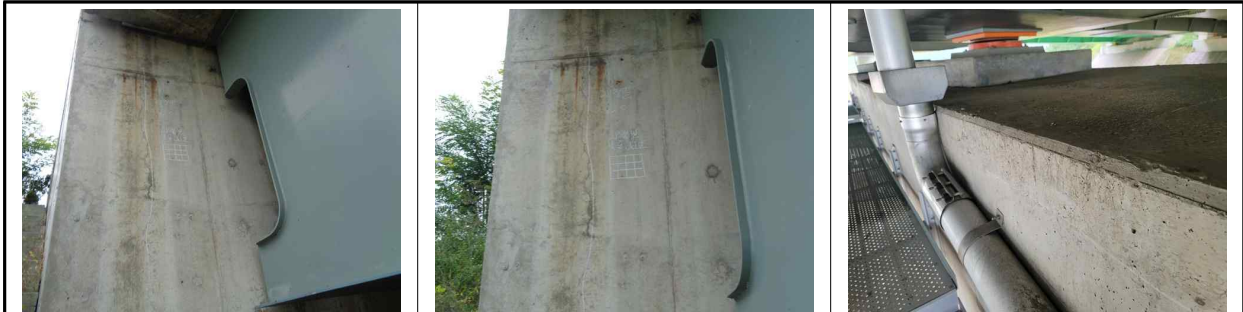
① 하부구조 균열(0.3mm 이상) 및 박리 파손 등 - 진전 여부확인
