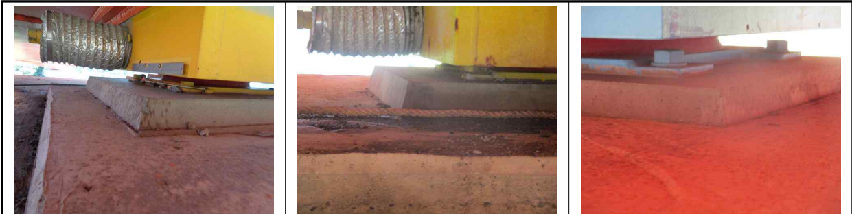
① P2, P4, P5 교량받침 무수축물탈 및 받침콘크리트 박리, 박락 - 진전 여부확인, 2차 손상 발생여부 확인
